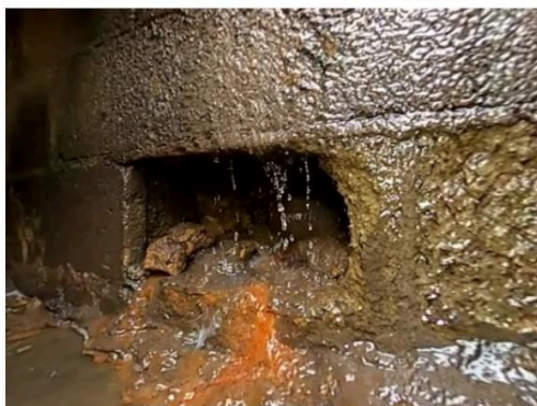
Hole Void Visible
